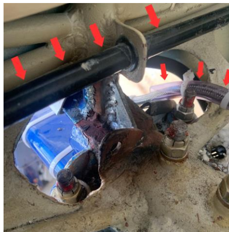
Figura 13 – Identificação dos conduítes Figure 13 – Identification of conduits
