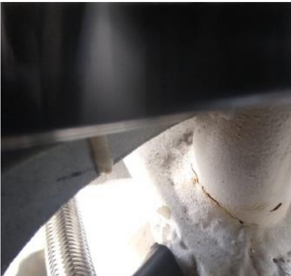
Figura 3 – Rachadura no tubo vertical de aço 4130 1" x 0,058"
