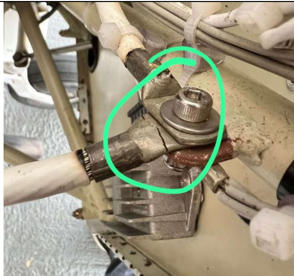
Figura 1 – Demonstração da rachadura no cabo Figure 1 - Demonstration of the crack in the cable
