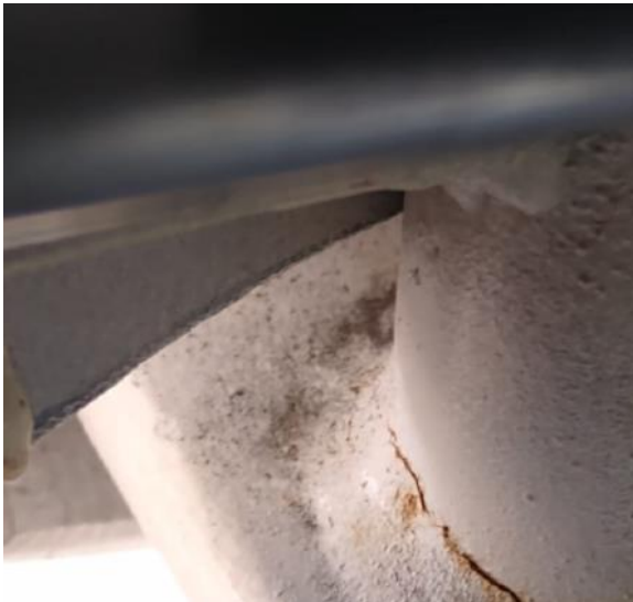
Figura 1 – Demonstração da rachadura no tubo vertical de aço 4130 1" x 0,058"
