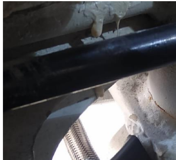
Figura 2 – Observação da rachadura no tubo vertical de aço 4130 1" x 0,058"
