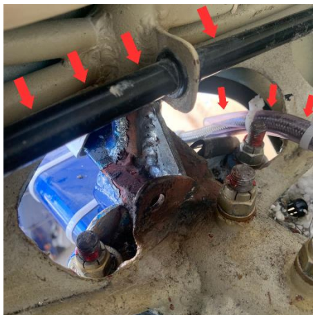
Figura 13 – Identificação dos conduítes Figure 13 – Identification of conduits
