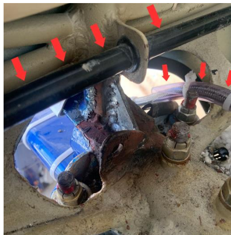
Figura 13 – Identificação dos conduítes Figure 13 – Identification of conduits
