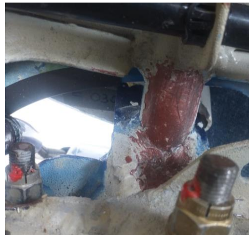
Figura 10 – Vista 2 da área do metal lixada Figure 10 – View 2 of the sanded metal area
